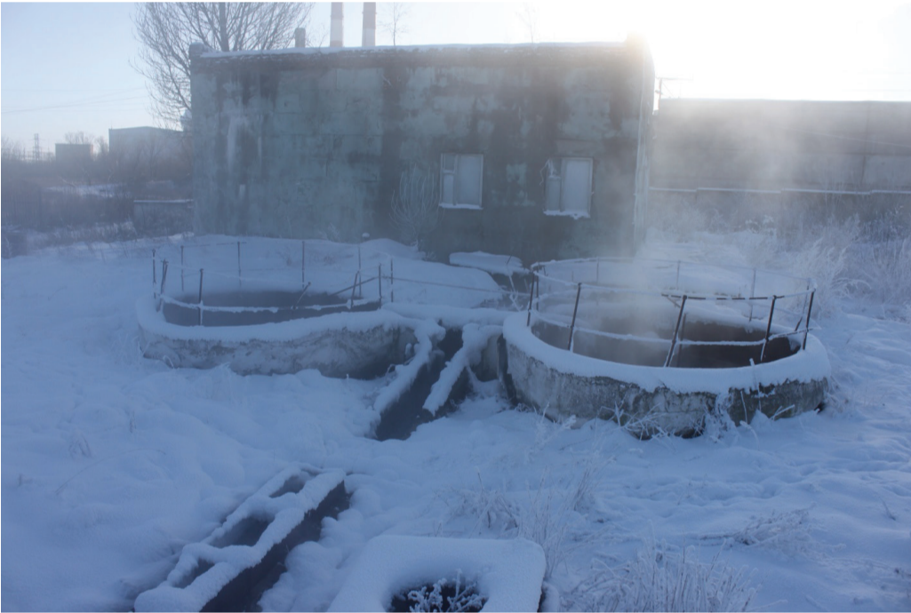
очистные сооружения полной биологической очистки. Водоприемником хозяйственных стоков является р. Деготня.
